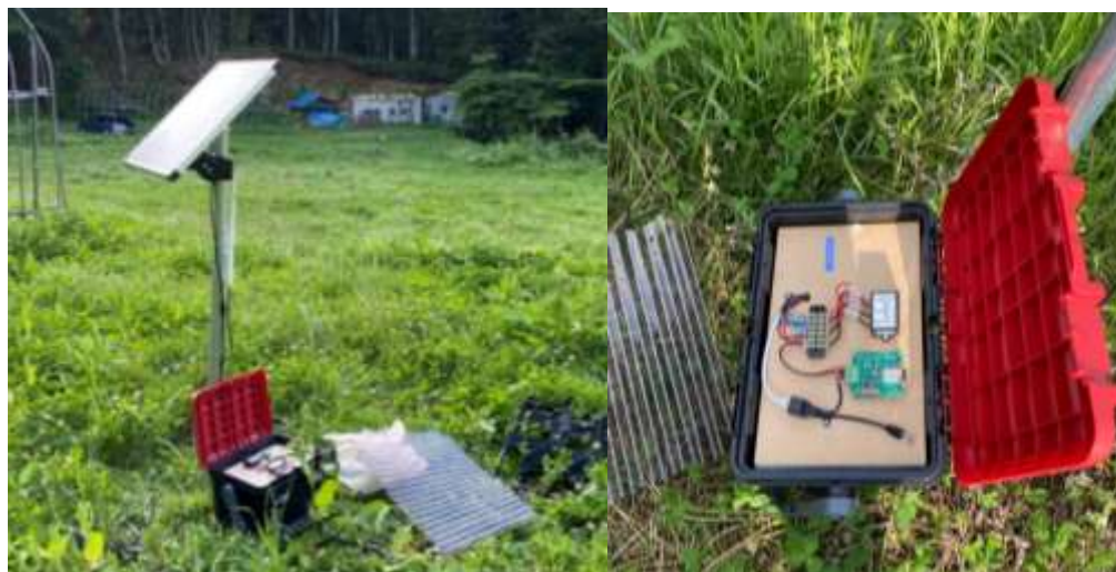
図 7 中継機の設置方法、鉄杭にソーラーパネルと中継機を取り付け、地面に防水ボックスに入れた蓄電池を設置。
