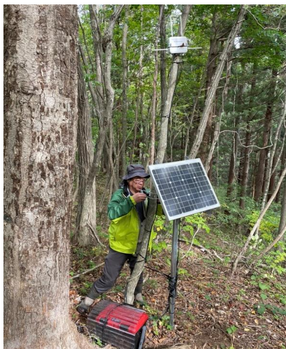
図 2-18 中継器の設置
