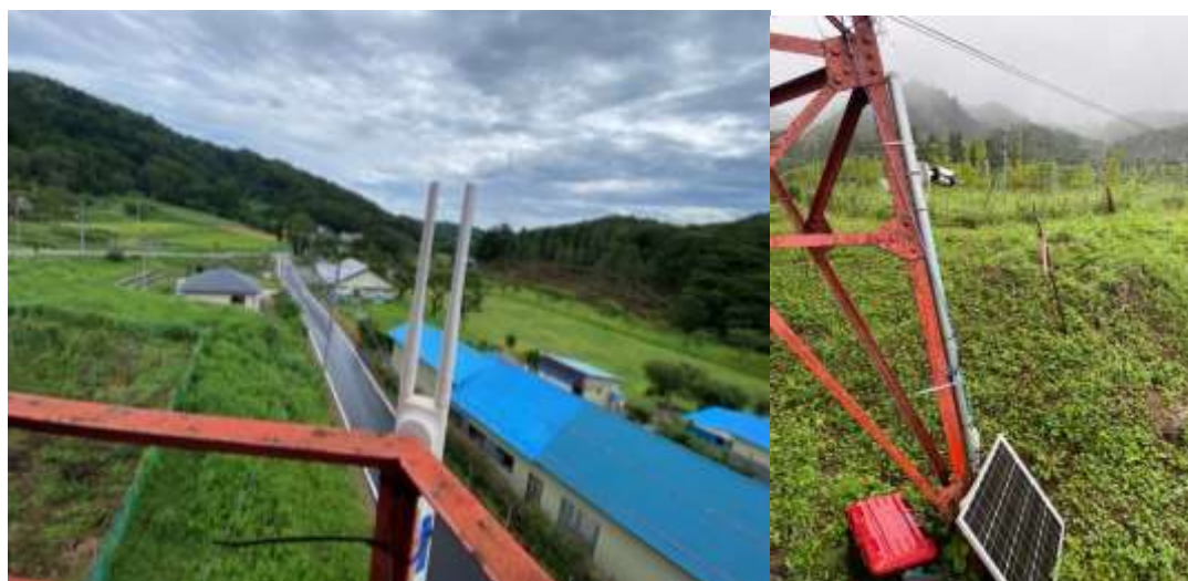
図 8 櫓の上部に設置した Wi-Fi 中継アンテナ (EAP225-OutdoorV1, Omada 社製) (左)、櫓下部にはソーラーパネルと蓄電池ボックスを設置 (右)
