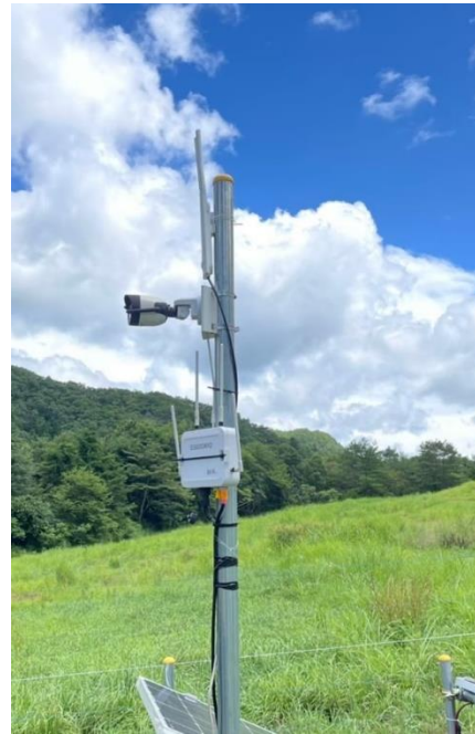
図 2-16 (左) 親機 ES920GWX2 (Easel 社より) [38] (右) 現地に設置された様子
